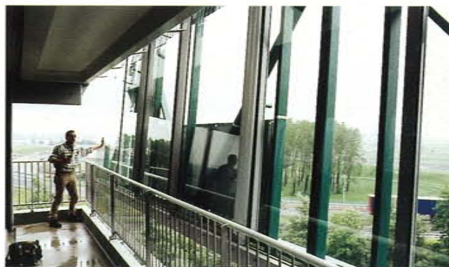
De prefab puien worden met een speciale hijsbeugel van de glasboks gehesen.
