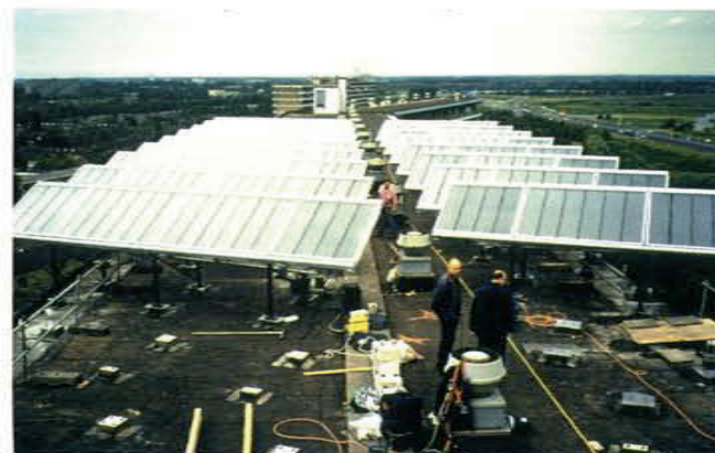
Installatie 760 m 2 zonnecollectoren op de Brandaris, Zaandam.
