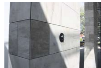
Hoeken in verstek gezaagd en zorgvuldige plaatsing van bijvoorbeeld camera's en behuizingen voor noodverlichting.
