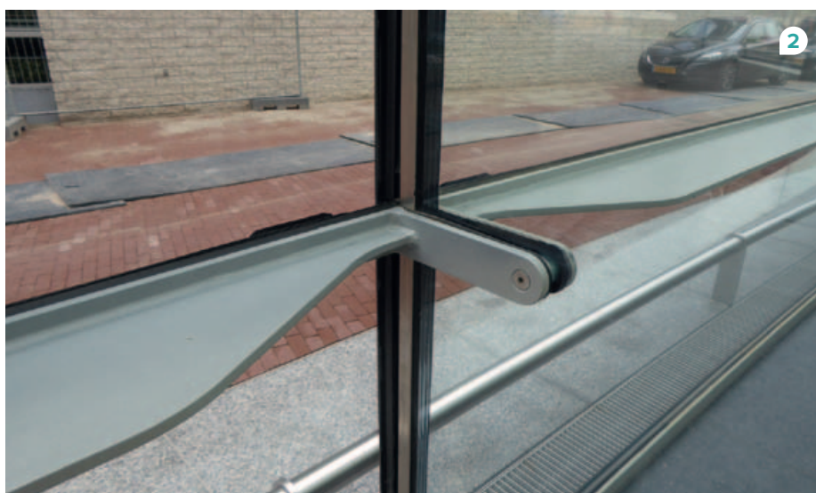
1 // De glazen gevelvinnen zijn met een pendel aan de stalen buisconstructie gekoppeld en blijven los van het dak. (Foto: Ronald Tilleman) 2 // De horizontale krachten op de gevel worden via een puntbevestiging ingeleid naar de vinnen toe via de versmalde stalen ribben.
